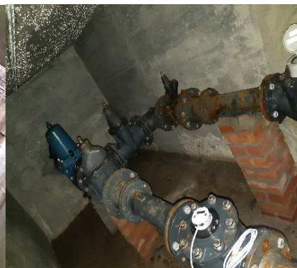
Armaturen: Schieber, Zähler, Druckminderer
