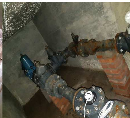
Armaturen: Schieber, Zähler, Druckminderer
