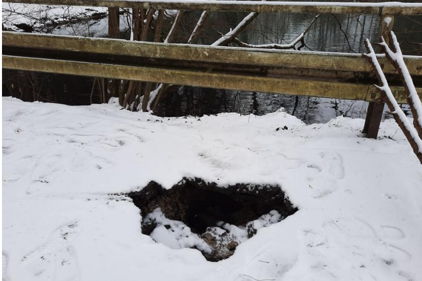
Abbildung 3: eingebrochene Dammkrone (fotografiert am 09.02.2021)
