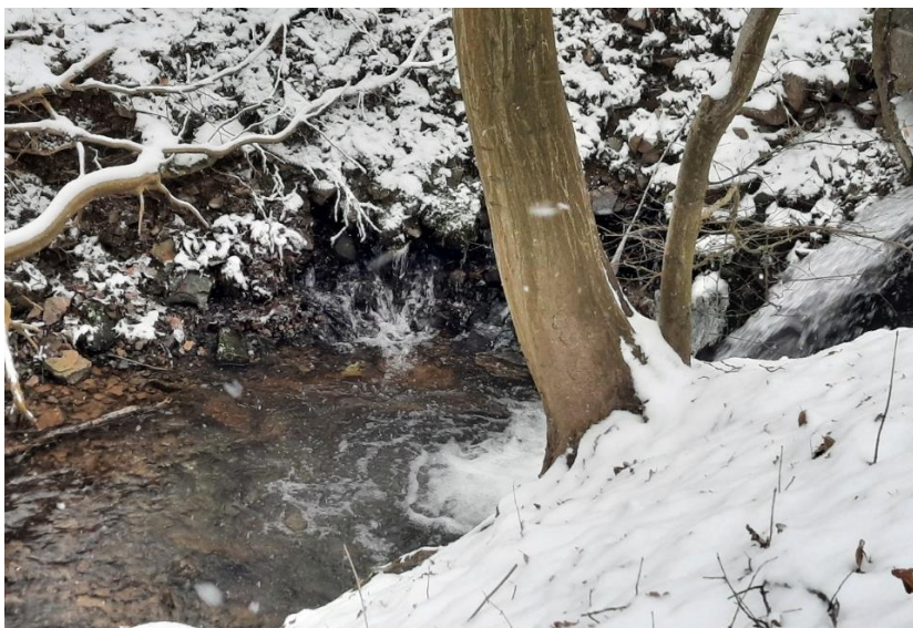
Abbildung 4: Wasseraustritt am Böschungsfuß (fotografiert am 09.02.2021)
